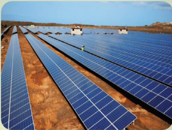
2.5 MW Solar PV
