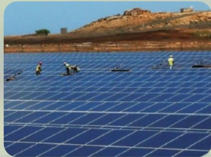
5 MW Solar PV
